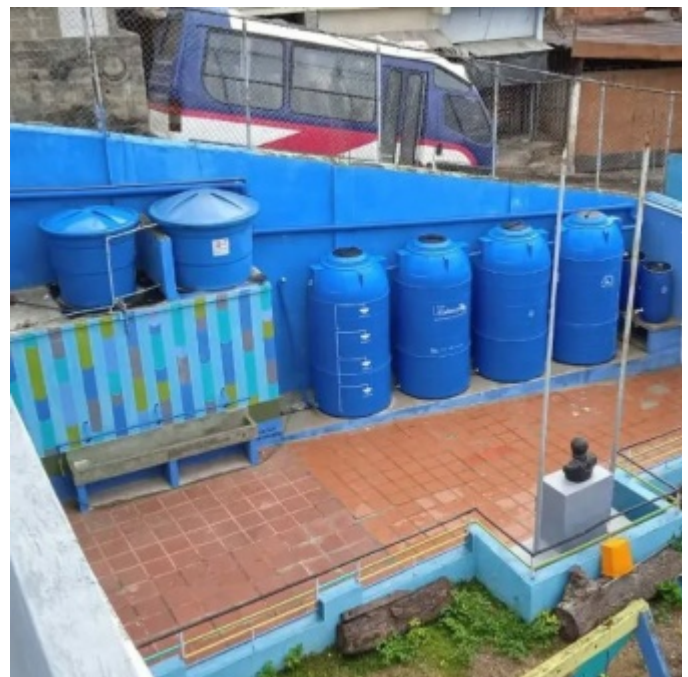
Figura 4. Modelo de captación, tratamiento y almacenamiento de agua de lluvia en Barrio Nuevo, Petare, Caracas Fuente: @latadeagua_ (2022)
